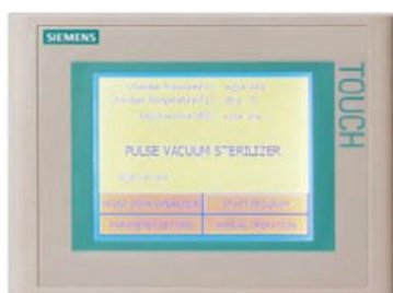
SIEMENS Touch Screen Display
